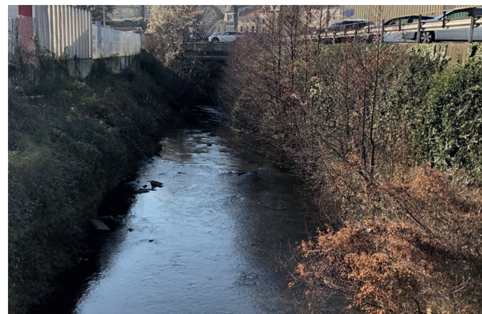
Vues du caractère endigué du lit de la Boivre et de sa physiologie de corridor étroit n'influençant plus ses marges riveraines (désormais urbanisées/imperméabilisées) - (Clichés Biotec, 25.01.2022)
